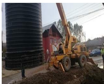
CL7-SPAU3-montat stație de pompare apă
